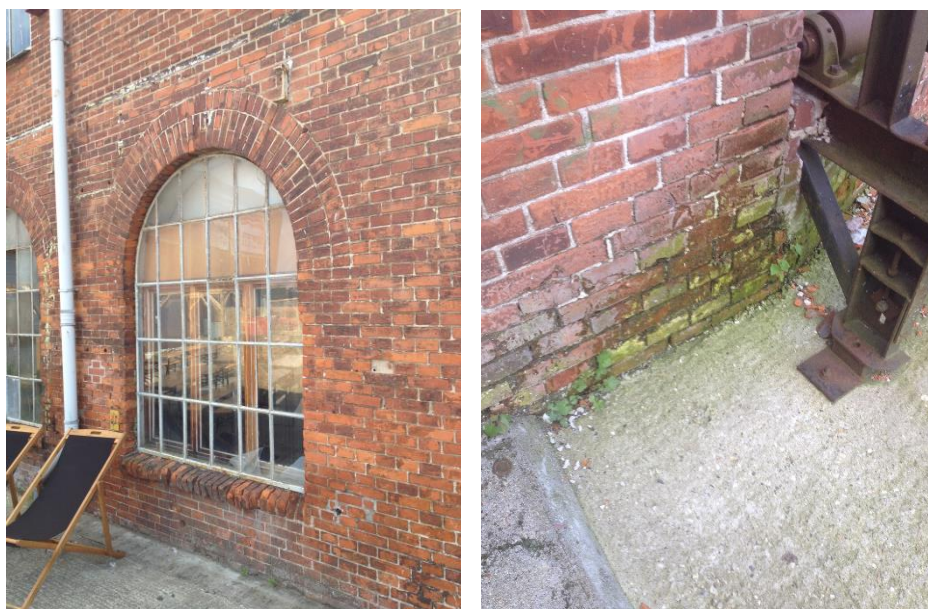
Nedbrudte mursten under vindue og ved delvist indmuret konstruktion.
